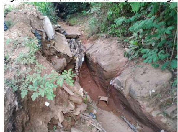
Figura 8 – Presença de erosão nas margens do córrego
